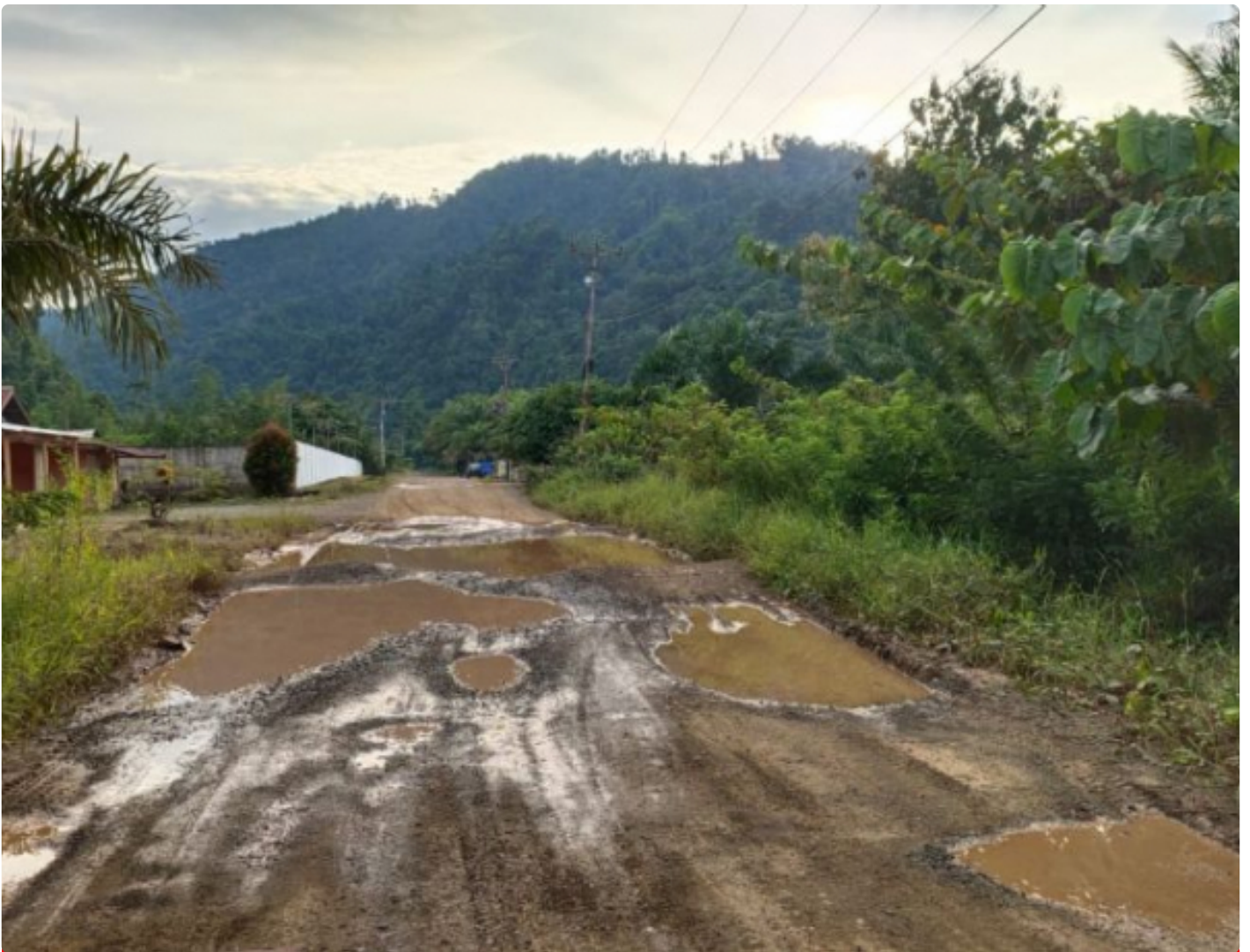
Tampak jalan poros Bimorjaya Mirip Kubangan Kerbau
